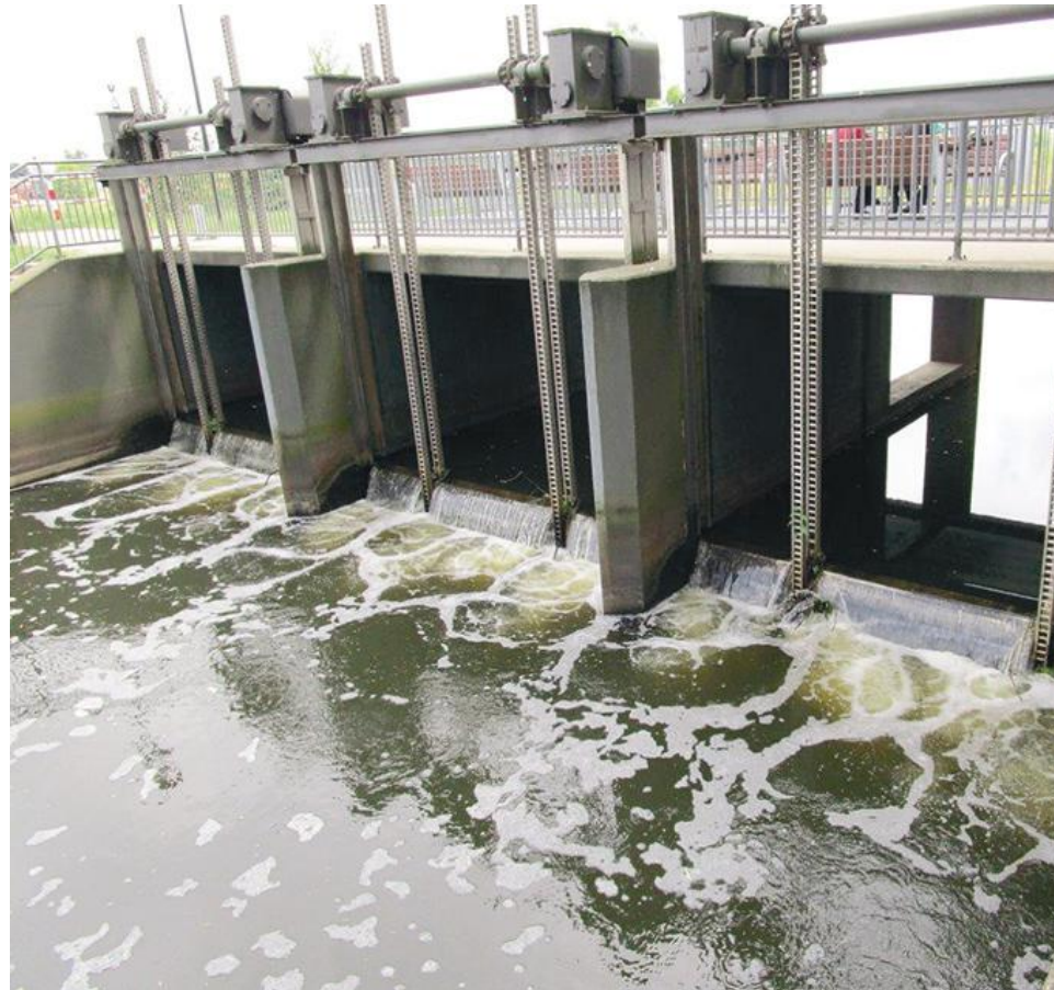
Obiekty hydrotechniczne administrowane przez Wody Polskie powinny być obsługiwane tylko przez upoważnionych pracowników Wód Polskich.
