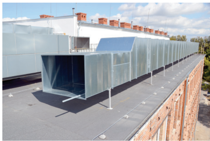
Na dachu szpitala zainstalowano urządzenia tzw. czerpni powietrza.
