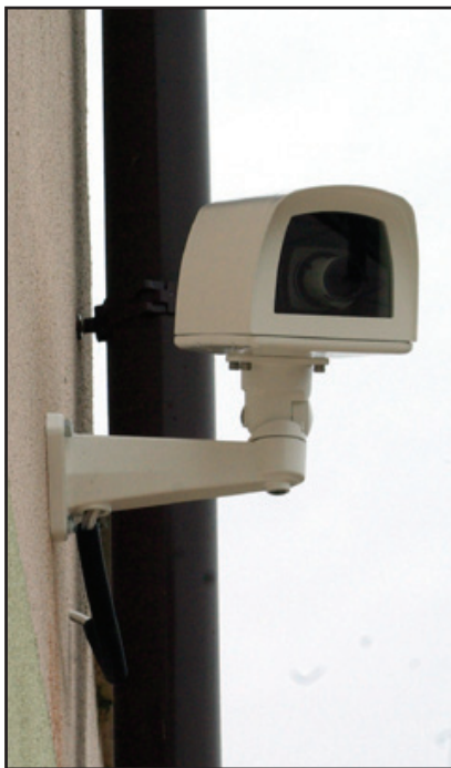
16 kamer czuwa nad bezpieczeństwem mieszkańców domu.
